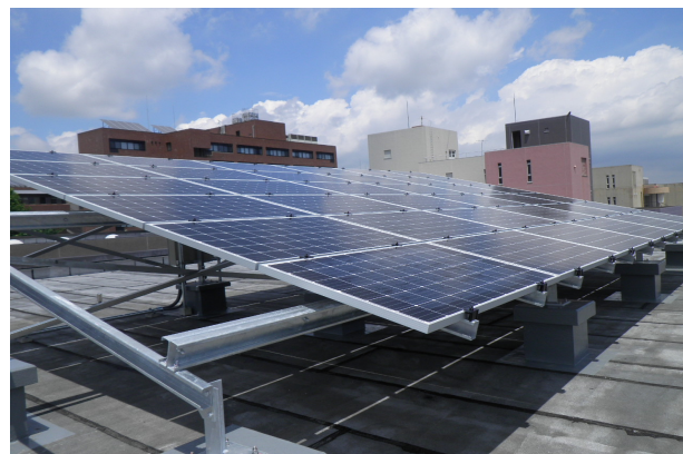
1D棟屋上太陽光パネル
