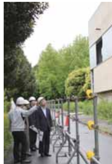
総合体育館 外部の破損
