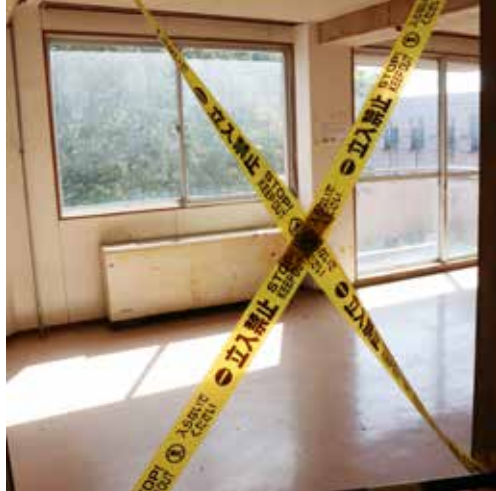
追越宿舎23号棟の共用スペース(10月7日撮影)にアスベストを含む建材が見つかった。だが、建築現場の飛散は確認されなかった。
