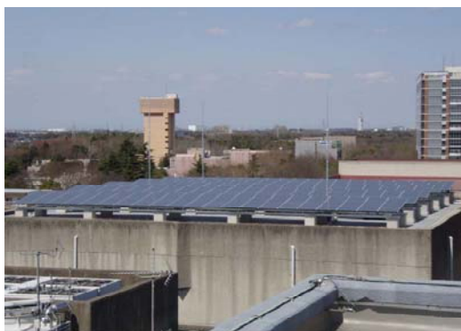
大学会館太陽光発電設備設置
