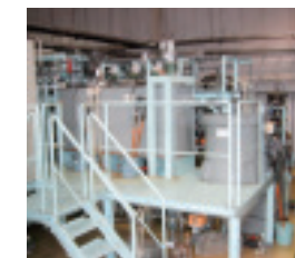
(D) 凝集・沈降槽
