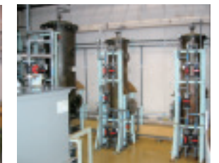
(E) 活性炭・キレート樹脂塔
