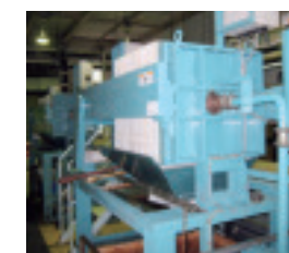
(F) 沈殿ろ過・脱水機
