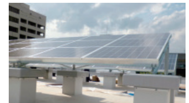
中央機械室屋上太陽光パネル
