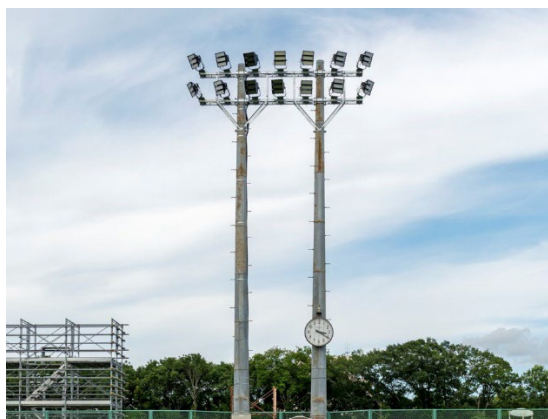
第一サッカー場照明塔 (LED照明器具)
