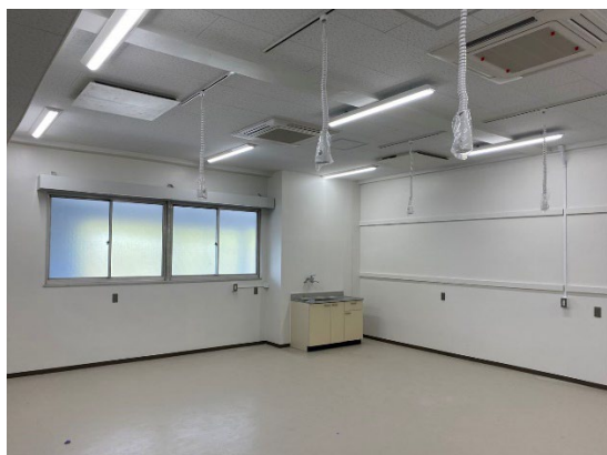
自然系学系A棟 (LED照明器具)
