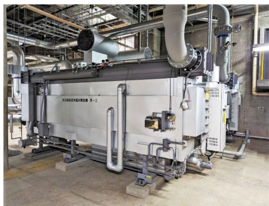
大学会館A棟 (ガス吸収式冷温水発生機)
