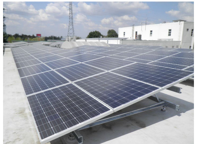
中央機械室屋上太陽光パネル
