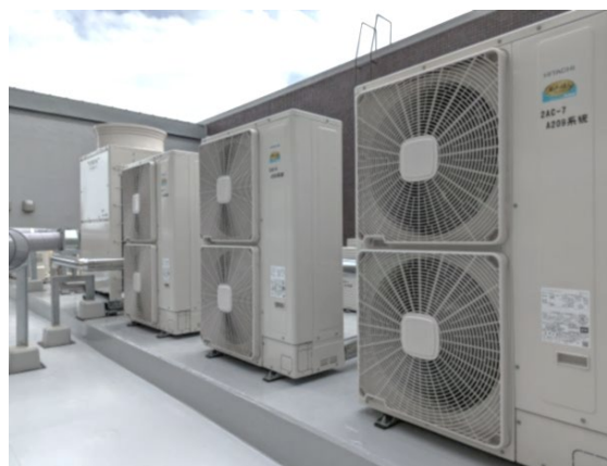
自然系学系A棟 (電気式空調機)
