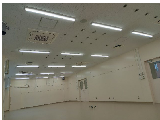
生物・農林学系D棟 (LED照明器具)
